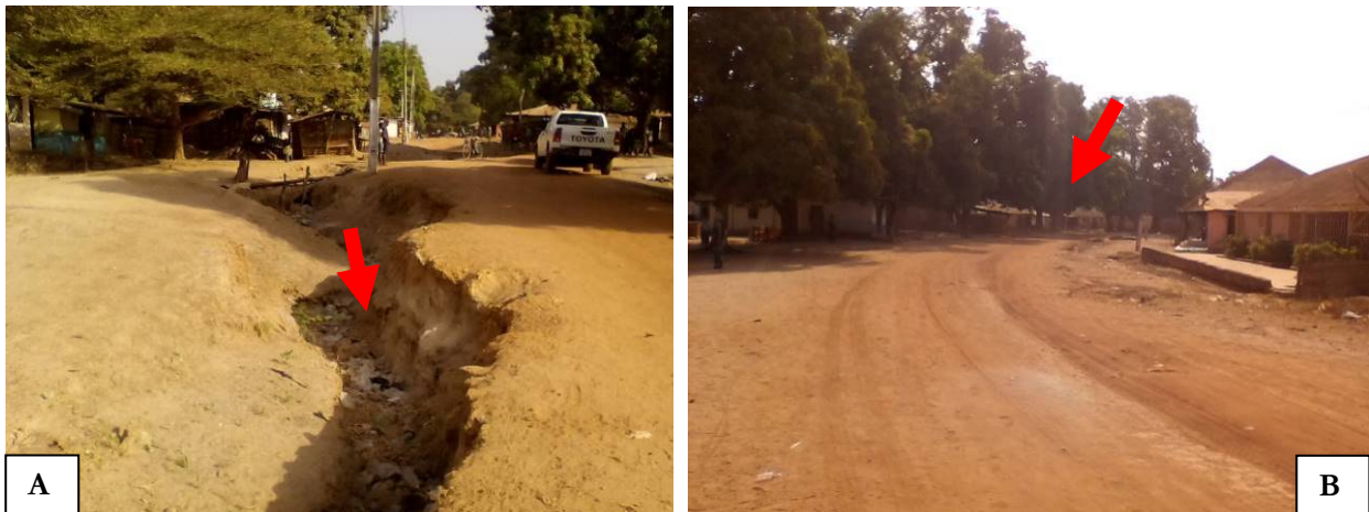
Photos 2/AGEIM-IC: Aperçus de dégradations (A) et d'un virage non signalé par un panneau (B) à la traversée de la localité de Farim/Février 2021
