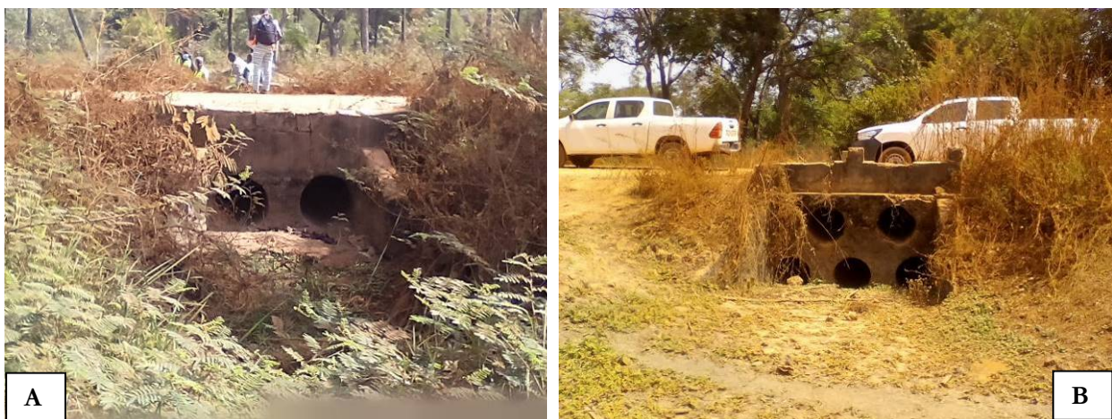
Photos 7: Vues partielles de passages d'eau avec des ouvrages de franchissement au PK03+500 (A) et au PK10+750 (B)/Février 2021
